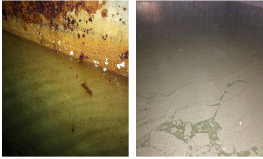
Şekil 1. a. Temizliği yapılmayan galvaniz depo b. Temizliği yapılmayan fayans depo
