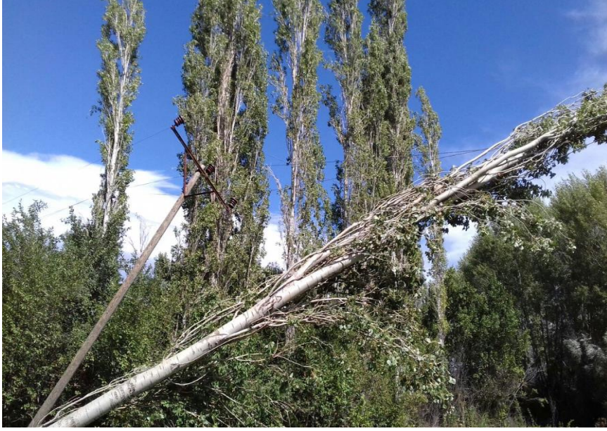
Şekil 11. Ağaç yıkılması sonucu oluşan arıza
