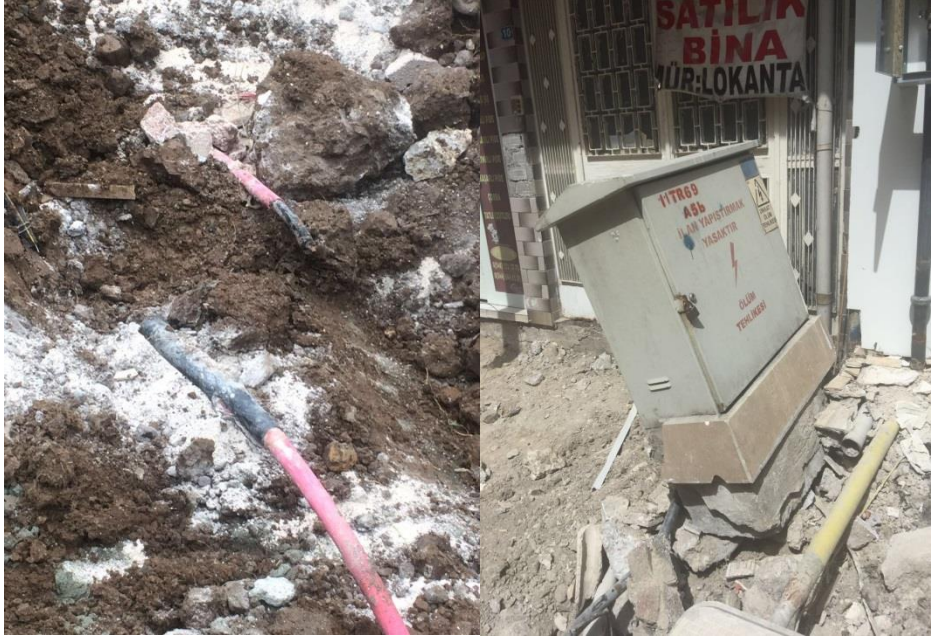
Şekil 12. İzinsiz yapılan kazılar sonucu oluşan arızalar
