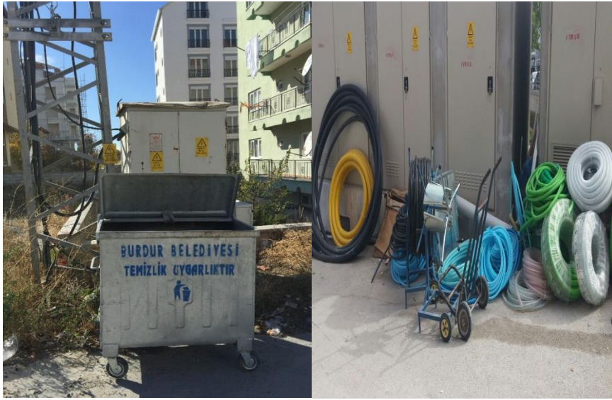
Şekil 13. Acil durumlarda arızaya müdahaleyi engelleyen haller
