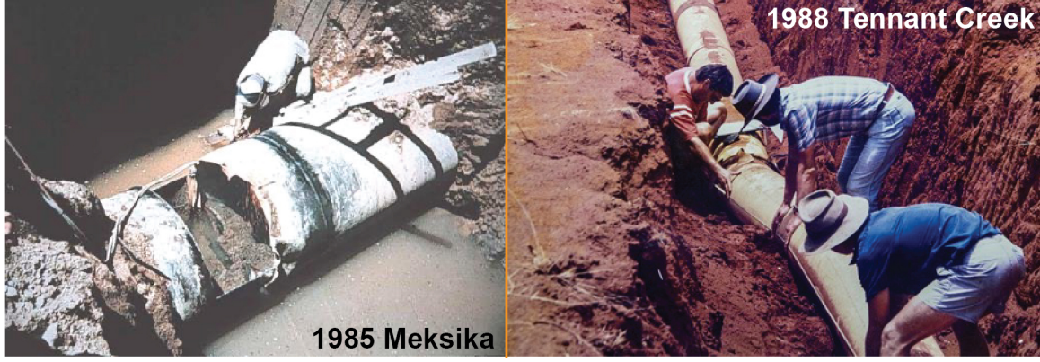
Şekil 1. 1985 Meksika ve 1988 Tennant Creek depremlerinde gömülü içme suyu ve gaz boru hatlarının depremlerle ilişkili yapısal hasarları (Flores-Berrones & Liu, 2003; Maddocks & Dunlevie, 2016).
