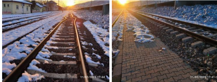
Şekil 7. Gölbaşı İstasyonu yollarındaki yanal atılımlar ve deprem etkisiyle devrilen vagonlar
