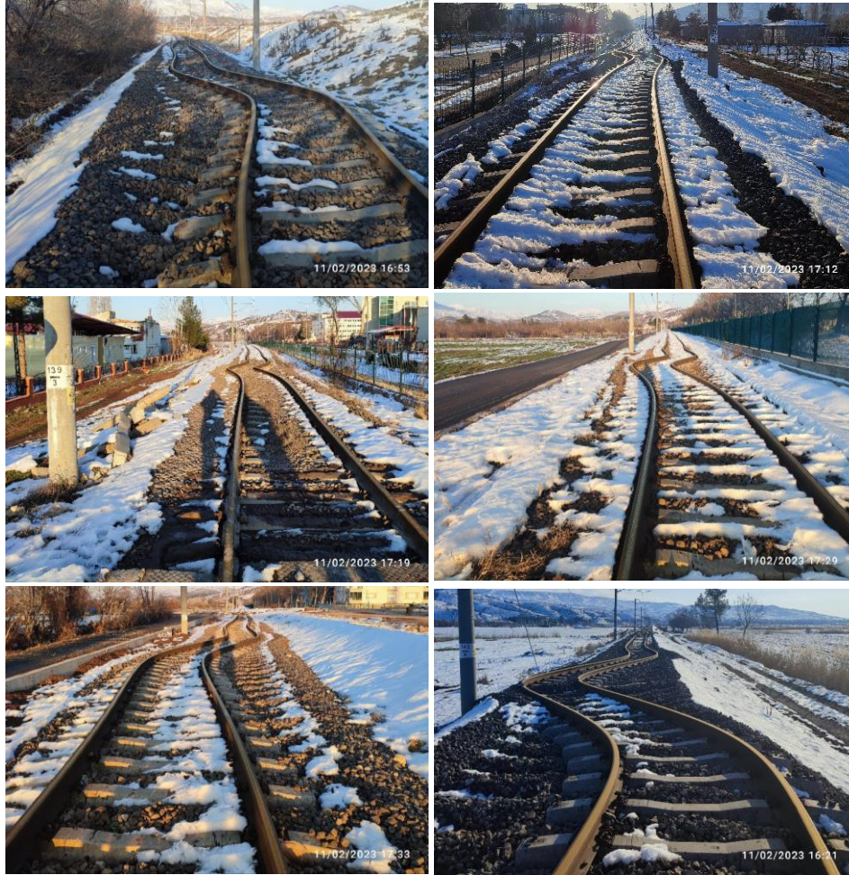
Şekil 4. Saha gözlemleri esnasında tespit edilen çeşitli S-tipi yanıl üstyapı salınımları
