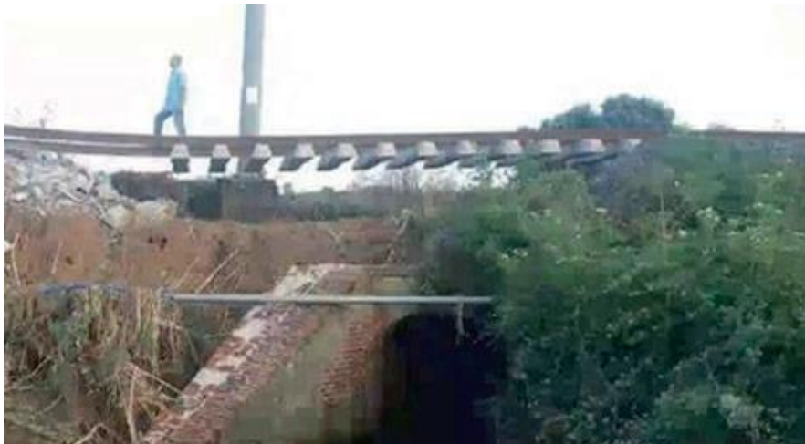
Şekil 20. Rayların altındaki dolgunun boşalması sonrası ortaya çıkan görüntü [14]
