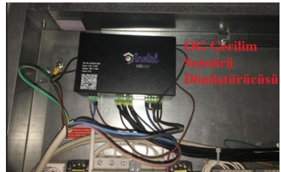
Şekil 10. OG tarafı gerilimlerinin ölçümü için kullanılan sensörlerin ve dönüştürücünün görünümü (Views of sensors and transducer used for measurement of MV side voltages)
