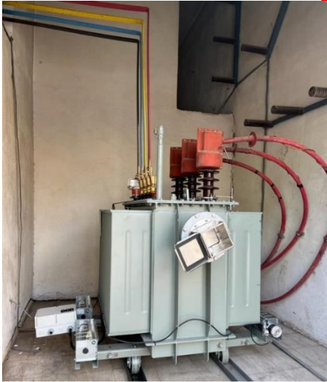
Şekil 9. Ömür sayacı cihazı ile izlemenin yapıldığı transformatöre ait bir görünüm (A view of the transformer that is monitored with lifetime metering device)
