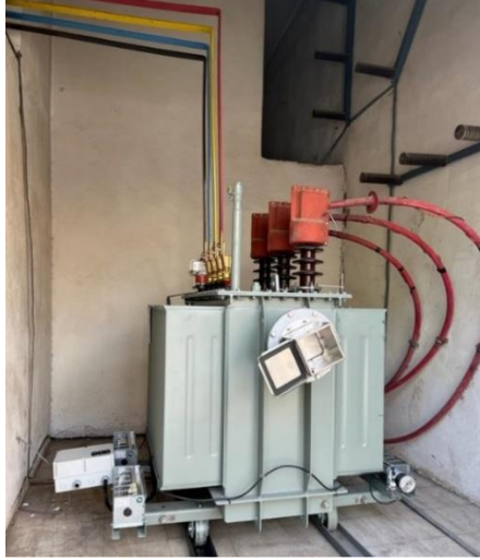
Şekil 9. Ömür sayacı cihazı ile izlemenin yapıldığı transformatöre ait bir görünüm (A view of the transformer that is monitored with lifetime metering device)
