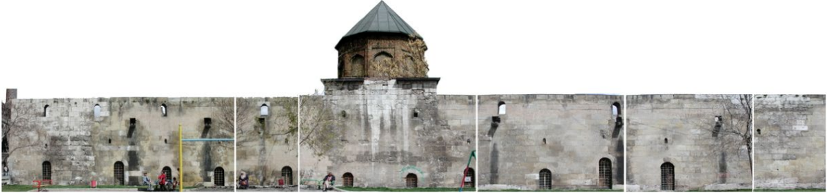
Fotoğraf 16: Darüşşifa güney cephesinde oluşan yüzey kirliliği 2005 (V.G.M. Arşivinden)
