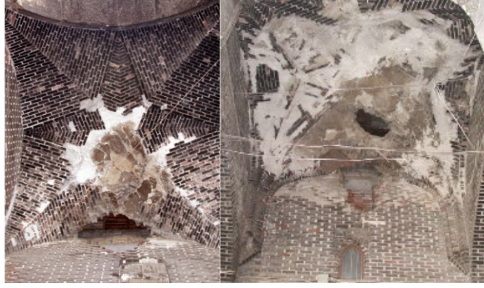
Fotoğraf 10: 23 ve 27 numaralı oda önünde yer alan çapraz tonoz örtüde oluşan bozulmalar 2005 (V.G.M. Arşivinden)
