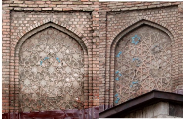
Fotoğraf 22: Türbe kasnağında yeralan sırlı tuğla süslemeli pano, onarım öncesi (2005) (V.G.M. Arşivinden)
