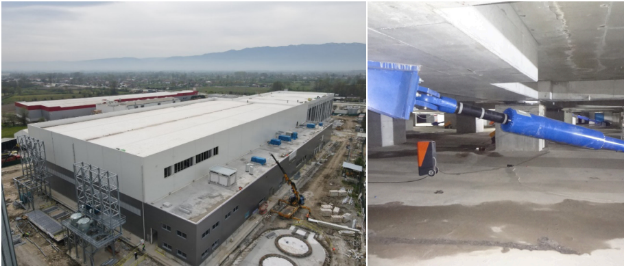
Şekil 7. Sismik izolasyonlu ana üretim binası ve sürtünmeli sarkaç izolatör-viskoz damper.
