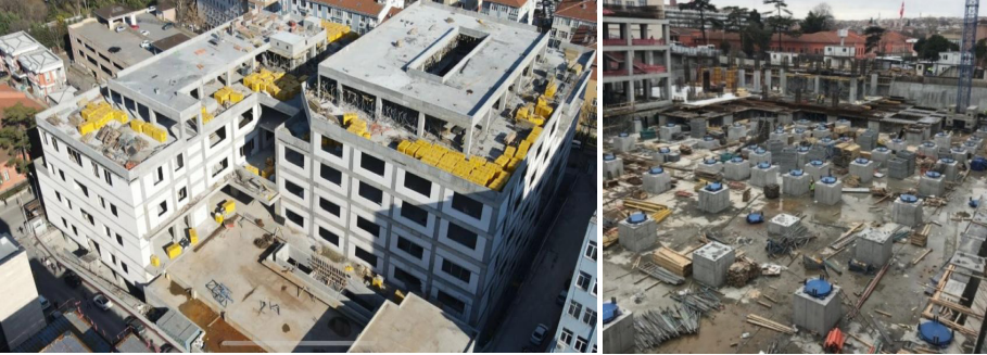
Şekil 4. İstanbul Üniversitesi Hasdal Yerleşkesi, sismik izolasyonlu hastane binaları ve sürtülmeli sarkaç izolatörler (Fotoğraf: Ekşioğlu Karel Adi Ortaklığı)
