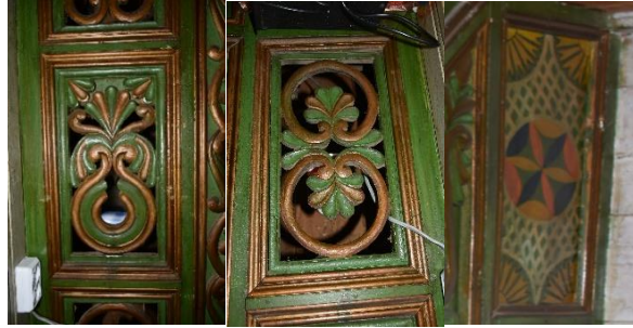
Görsel 18: Minberin Doğu ve Batı Cephesinde Köşk Altı Panolarından Detaylar
