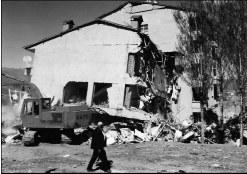
Fotoğraf 8. 1 Mayıs 2003 Bingöl Depreminde yıkılan ve ağır hasar gören konutlardan bir görünüm (Kaleöntü Mahallesi).
