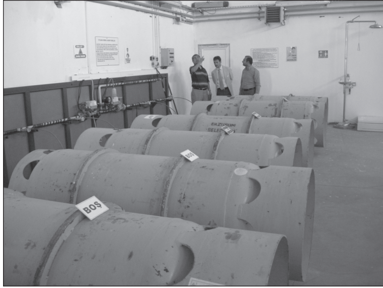
Fotoğraf 10: Arıtma Tesisindeki Klor Tanklarından Bir Görünüm.
