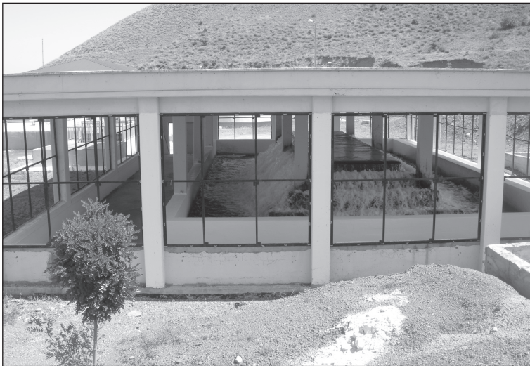
Fotoğraf 9: Erzurum Su Arıtma Tesisleri Havalandırma Ünitesinden Bir Görünüm.
