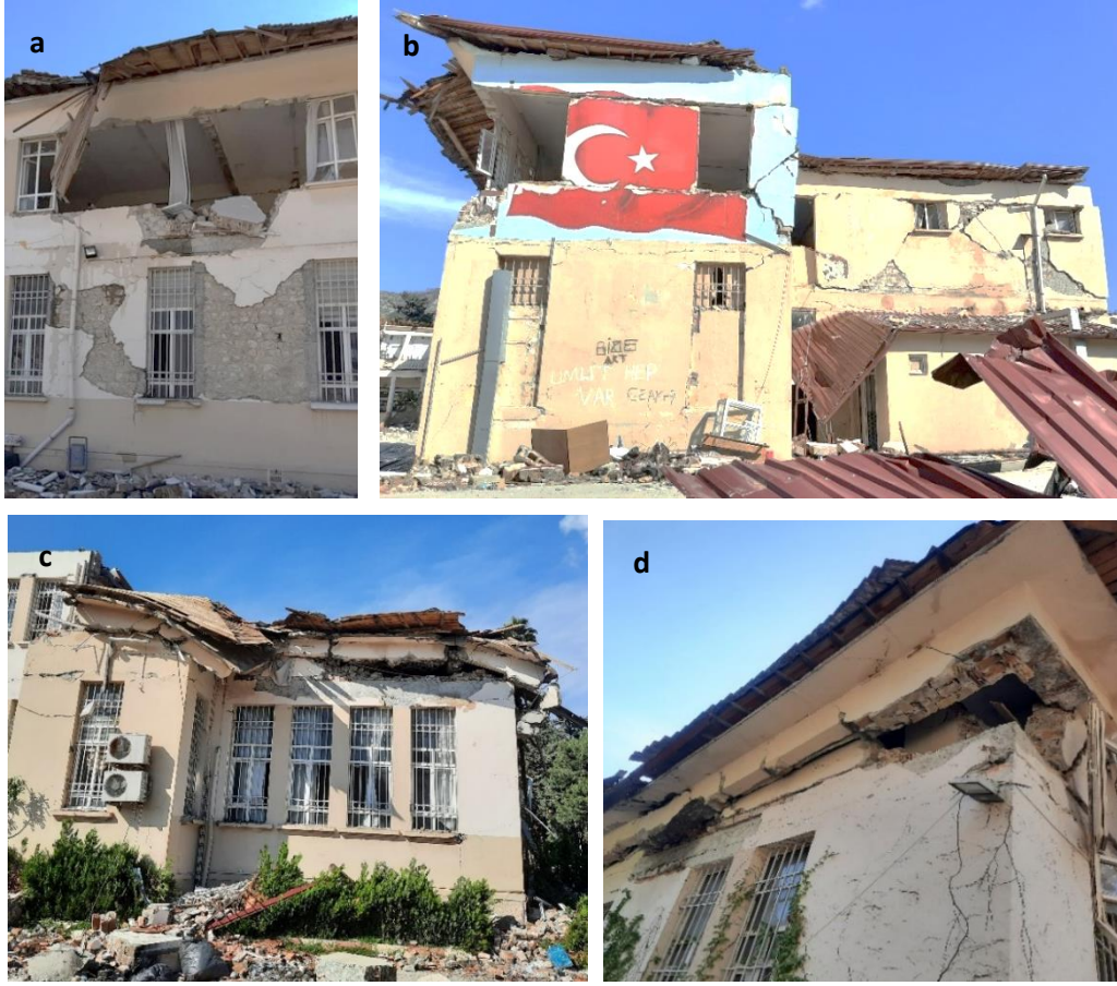
Şekil 11. Taşıyıcı dış duvarlarda alt kattaki moloz taş ve üst kattaki yatay delikli pişmiş toprak tuğla uygulamasına bağlı hasar düzeyleri a) 3 No.lu kolun avlu cephesi, b) 3 No.lu kolun güney cephesi, c) 2 No.lu kolun doğu cephesi, d) 2 No.lu kolun kuzey (giriş) cephesi
