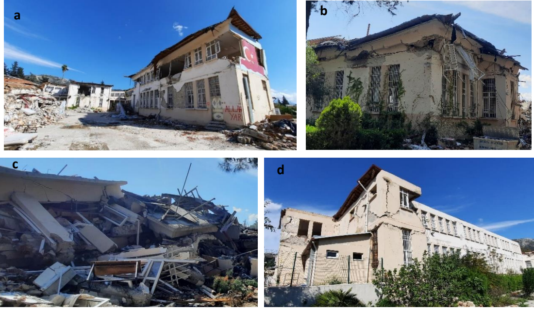
Şekil 5. a) Depremin genel etkisi b) Kısmi göçme c) Tamamen göçme d) Ağır hasar
