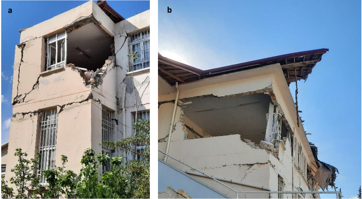
Şekil 10. Dış duvarın köşe bölgelerinde iki doğrultudaki düzlem dışı devrilme a) 3 No.lu kolun doğu cephesi b) 3 No.lu kolun batı (avlu) cephesi
