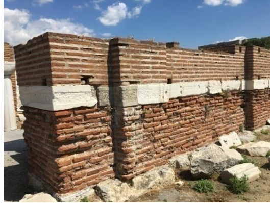
Şekil 3.3.2. Taş hatıl, St.Jean (Aziz Yahya) Kilisesi, İzmir (Figure 3.3.2. Stone lintel, St.Jean Church Izmir)
