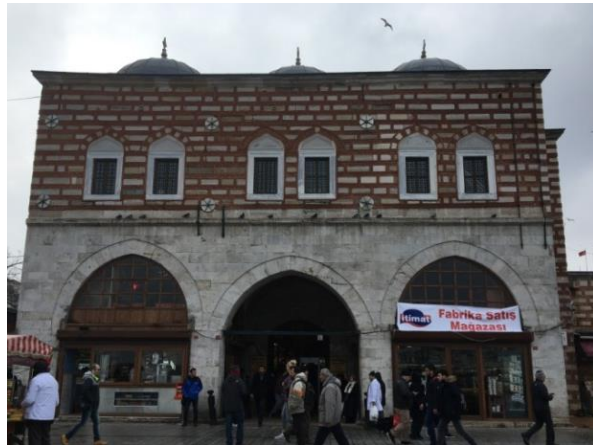
Şekil 4.1.7. Mısır Çarşısı Balıkpazarı Kapısı üstü odalarının paslanmaz çelik gergilerin cepheden görünüşü (Figure 4.1.7. Front view of the stainless steel tension rods of the rooms above the Spice Bazaar Balıkpazarı Gate)
