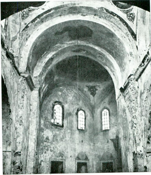
Res. 10 — Merkezi kubbenin bastığı doğu kemer. Fig. 10 — Eastern arch supporting the central dome.
