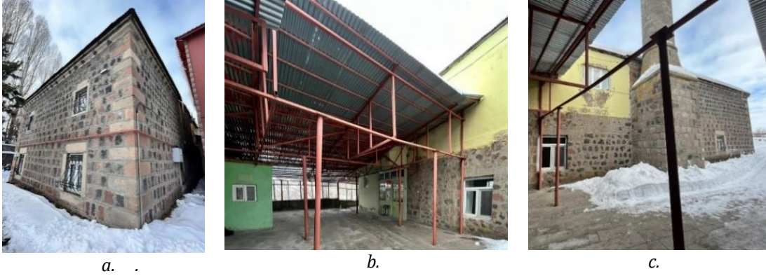
Şekil 16. Ardahan Derviş Bey Camii güney cephesi (a), kuzeybatı cephesi (b), güneybatı cephesi (c)
