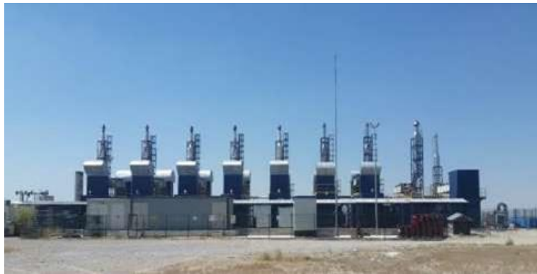
Görsel 7. Kaşınhanı Elektrik Üretim Tesisi
