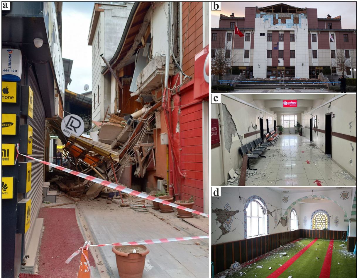
Şekil 15- 23 Kasım 2022 Gölyaka (Düzce) Depremi'nde meydana gelen yapısal hasarlara ilişkin fotoğraflar. a) Düzce şehir merkezinde ağır hasarlı bir işyeri, b) Düzce Adliyesi'nde meydana gelen yapısal hasar, c) Cumayeri ilçesi (Düzce) Belediye Ek Hizmet Binası'nda meydana gelen yapısal hasar (Kaynak: Anadolu Ajansı, https://www.aa.com.tr/tr/gundem/duzcedeki-depremdede-cumayeri-ilcesindeki-kamu-binalari-hasar-gordu/2746297 ), d) Sarıdere köyü (Gölyaka-Düzce) Cami'sinde meydana gelen yapısal hasar.
