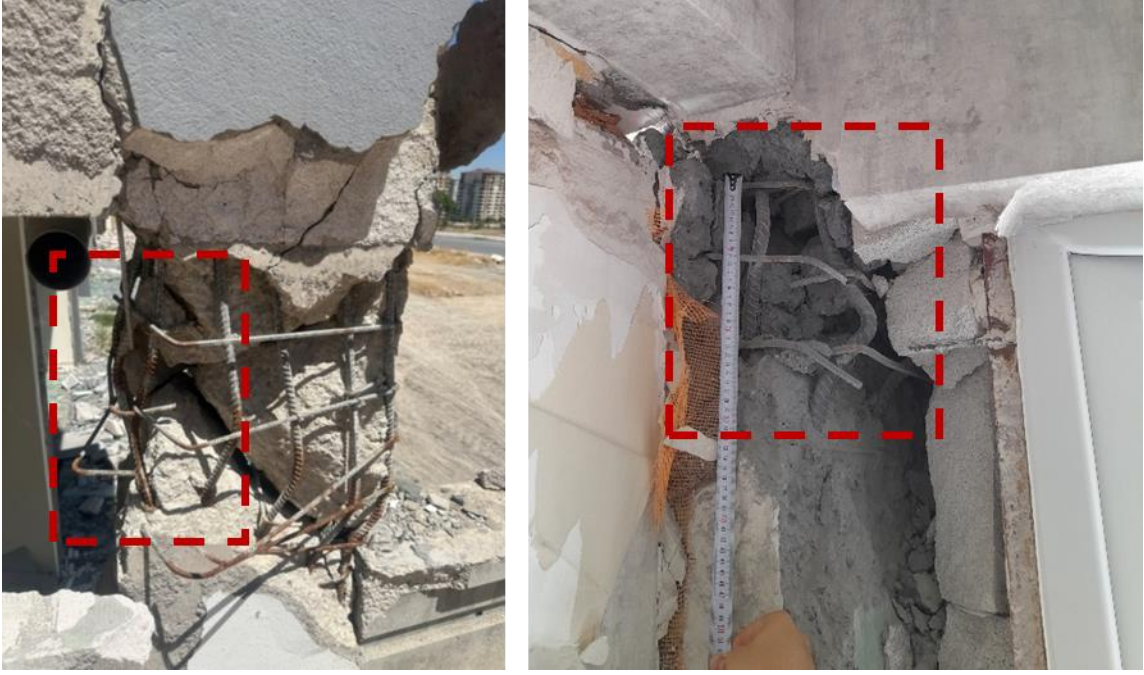
Şekil 11. 90° kanca açısına sahip kolon enine donatılarında açılma
