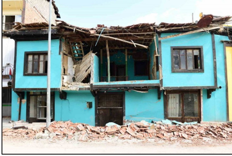
Fotoğraf 6. Depremde Hasar Gören Geleneksel Yeşilyurt Evi
