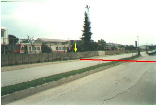
Şekil 8. Şekil 7'de 1 nolu bölge, duvarda çökme
