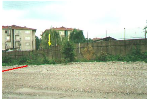
Şekil 9. Şekil 7'de 2 nolu bölge, duvarda çökme
