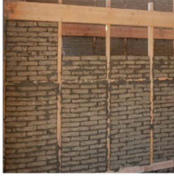
İç mekân bölme duvarlarında
