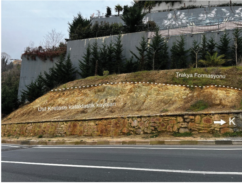
Şekil 8. Çırçirsuyu çeşmesi yakınında Trakya Formasyonu ile Üst Kretase kataklastik kayaları arasındaki yatay bindirme (Şekil 6'daki taban bindirmesi ile karşılaştırınız).
