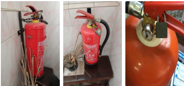
Resim 33. Bazı İşletmelerde Engellenmiş Yangın Söndürücüler
