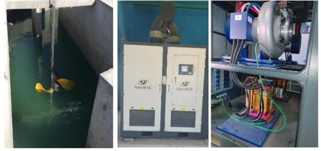
Şekil 10. Havalandırma havuzu mikseri ve havalandırma havuzu blower üniteleri
