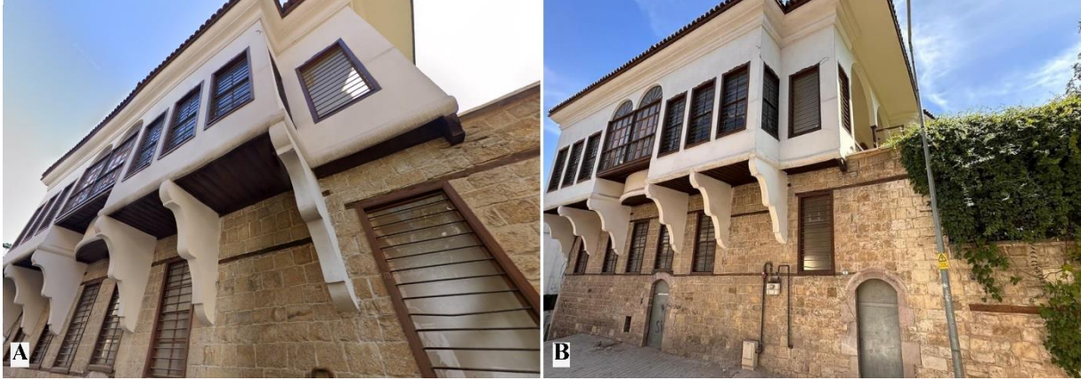
Şekil 13. Sivil Mimarlık Eserleri (Kocabaş Konağı) A: Depremden önce (Google Earth View, 2022); B: Depremden sonra (Yarım, 2023)
