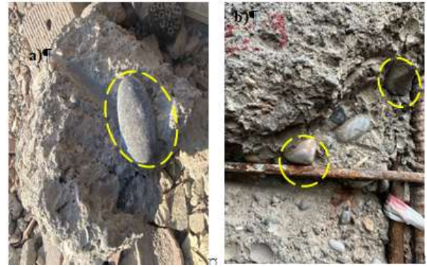
Şekil 3. Yapı enkazından alınan ve maksimum agrega tane çapı yüksek olan beton örneği (a), Ağır hasar alan bir yapıda maksimum agrega tane çapının aderansı üzerindeki olumsuz etkisi (b).
