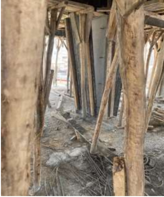
Şekil 4. Soğuk havada beton dökülen ve kalıp söküm işlemi yapılmayan betonarme elemanlar
