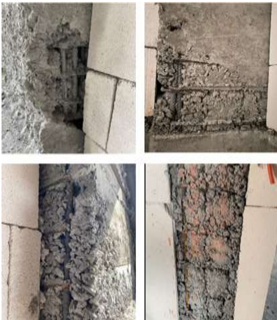
Şekil 5. Yapılarda gözlenen segregasyon oluşumları
