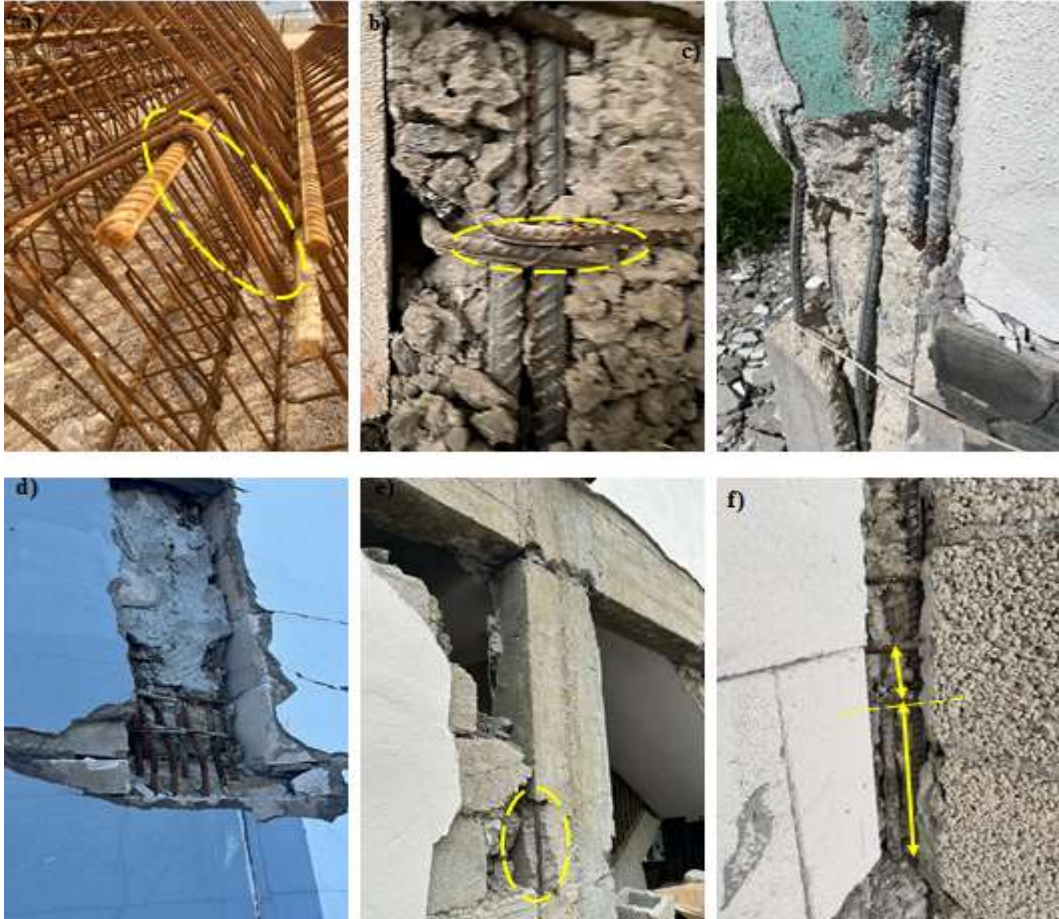
Şekil 7. Donatı işçiliklerinde gözlenen kusurlar
