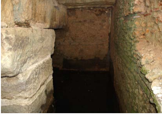
Fig. 11. Kremna, Dörtgen Sarnıç, Dikme, Kiriş ve Duvardaki Hasarlı Bölüm
