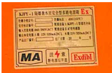
Şekil 5. Çin'de kullanılan bir Elektrik Panosuna ait MA logolu etiket örneği
