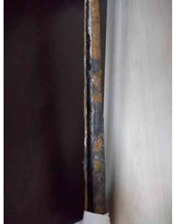
Şekil 3. Korozyona Uğramış Split-Set
