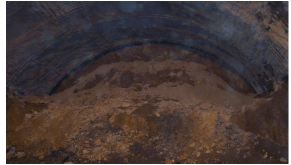
Şekil 5. İzmir Metrosu Üçyol-Üçkuyular hattı istasyon tüneli kazısında meydana gelen ayna akması.
