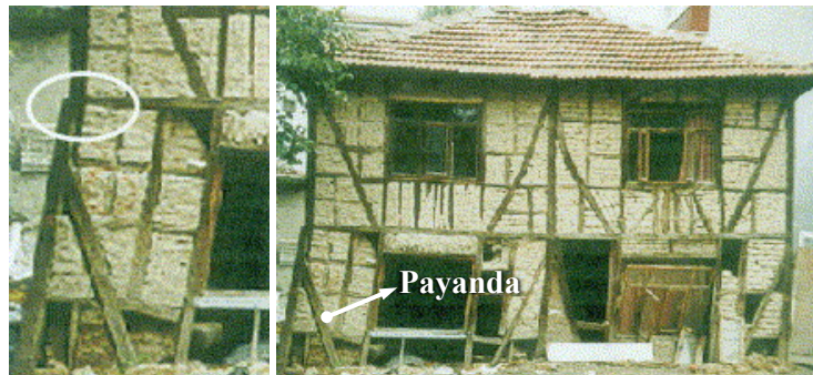
Şekil 7. Bağlantı noktasında hatalı uygulama, Kocaeli (Doğangün vd., 2006)
