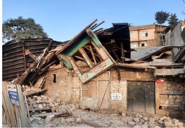
Şekil 6. Kahramanmaraş'ta üst katı göçmüş bağdadi tekniği ile inşa edilmiş ahşap yapı, 2023
