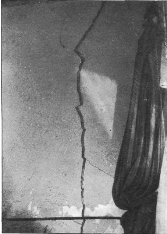
Fotoğraf 1. önemli bir düşey çatlakın görünümü.
