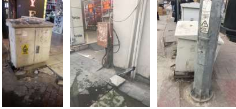
Şekil 9-10-11. Elektrik Panolarının Konumları (Location Of Electrical Panels)
