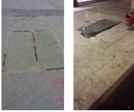
Şekil 24-25. Rögar Kapakları(Manhole Covers)
