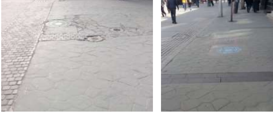
Şekil 4-5. Zemin Malzemeleri, Deformasyonları (Floor Materials, Deformations)
