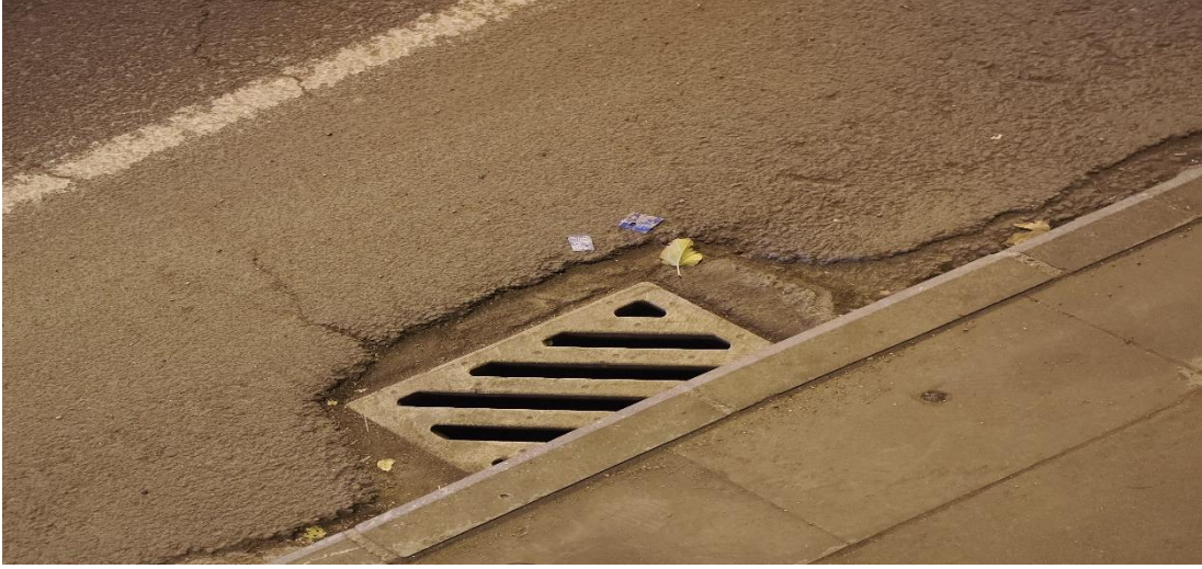
Şekil 9. Su tahliyesi yapılmaması sonucu oluşan tahribat
