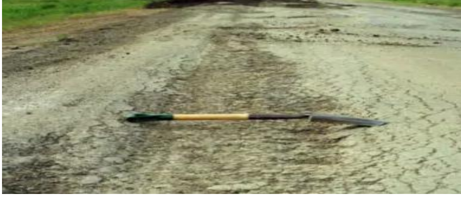
Şekil 1. Drenaj yetersizliğinden kaynaklı oluşan oturmalar
