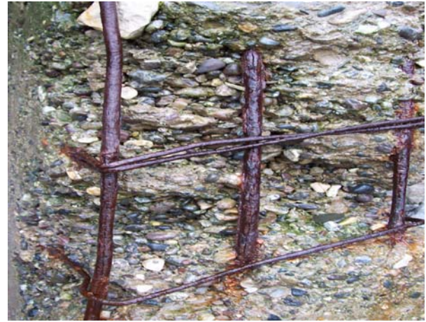
Şekil 7. Yeterli pas payı verilmemiş kolon içerisindeki inşaat çeliklerinin kesit daralması ve atmosferik korozyon
