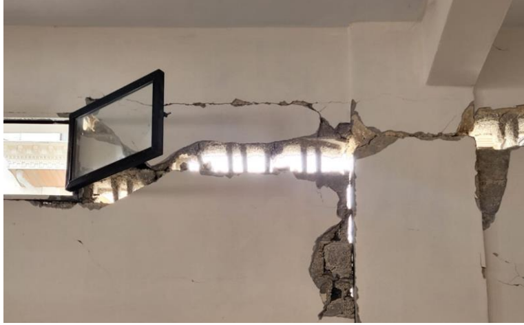
Şekil 9: Kısa kolon hasarı.
