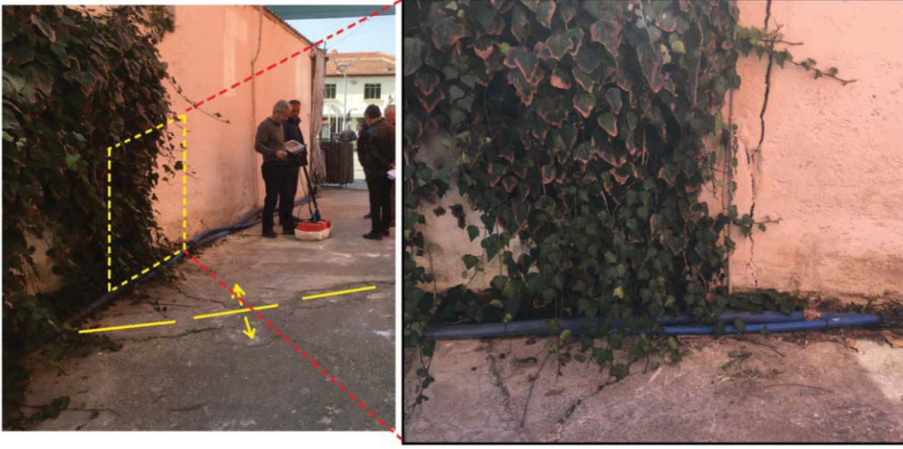
Şekil 10. Ara sokak içerisinde 24 nolu ölçüm güzergahı ile çatlağın genel konumu (batıya bakış) ve güney duvardaki açılma (güneye bakış).
