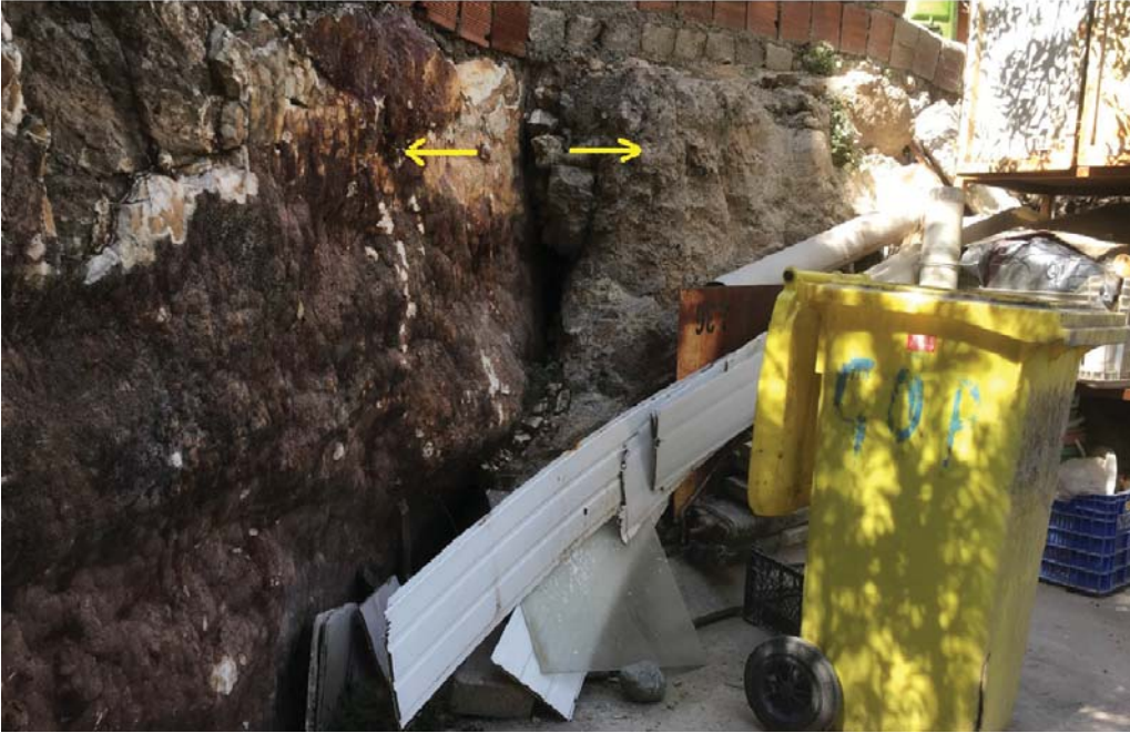
Şekil 11. 124 nolu sokakta gözlenen çatlak yüzeyi (kuzeye bakış).
