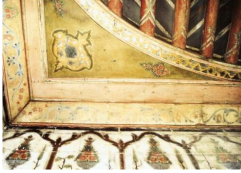
Şekil 24. Ahşap Dikmelerin Kısmi Olarak Kapatıldığı Tavan, Melek Dal, 2019.
