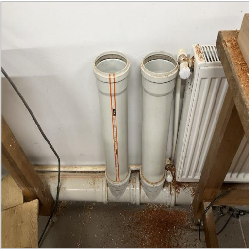
Şekil 5. PVC boru iletim hatları
