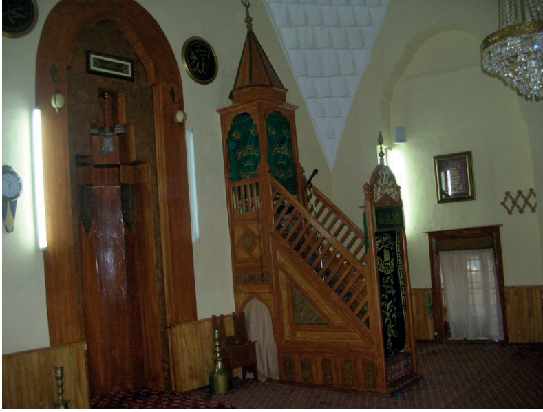
F.12- Edremit Kurşunlu Cami. Onarım öncesi mihrap ve minber.
