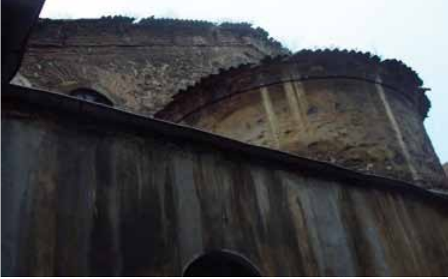
Şekil 33: Doğudan dışa taşkın dairesel apsis cephesi ve saçaktan detay – Restorasyon öncesi (M. Çıtak Arşivi)
