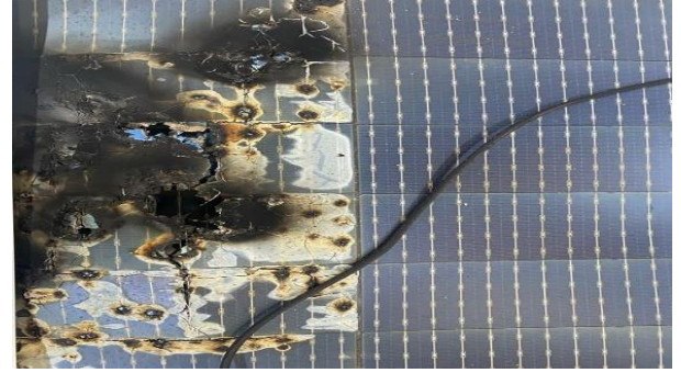
Şekil 5. Yanmış hücrelerden oluşan panel
