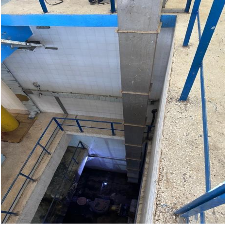
Şekil 17. Burhaniye TM8 Atıksu Arıtma Tesisi
