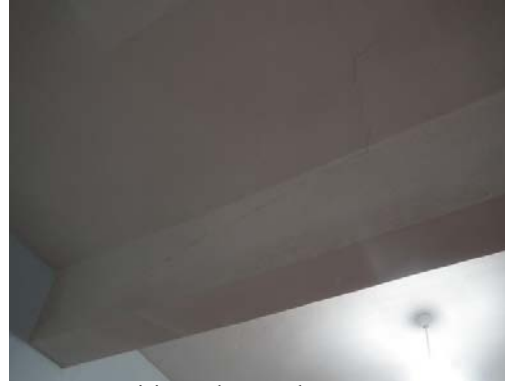
Kiriş ve döşeme hasarı
