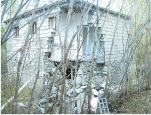
Yığma yapı hasarı
