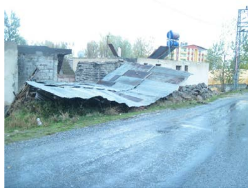
Göçmüş yığma yapı
