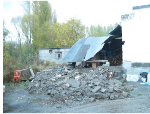
Yığma yapı hasarı
