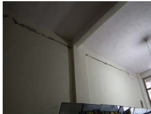
Betonarme çerçeve- duvar ayrılması
