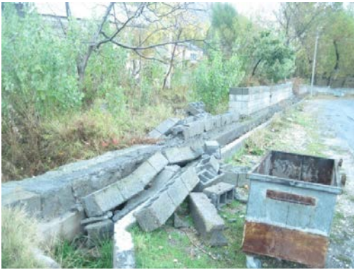
Çevre duvarı hasarı
