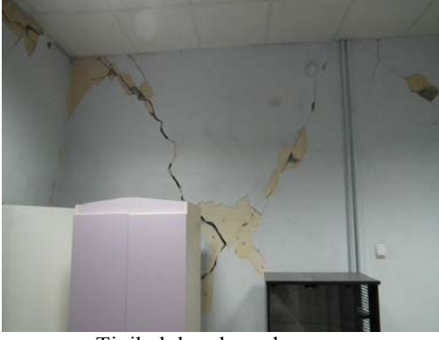
Tipik dolgu duvar hasarı
