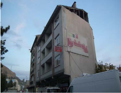
Çatı kalkan duvar hasarı
