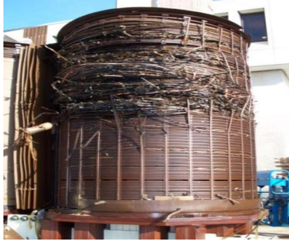
Şekil 1. Güç transformatörü sargısındaki bozulma
