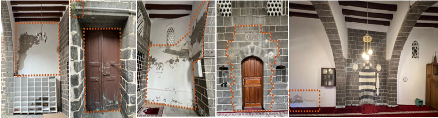
Şekil 31. Kavas-i Sağır Mescidinde tespit edilen sorunlar
