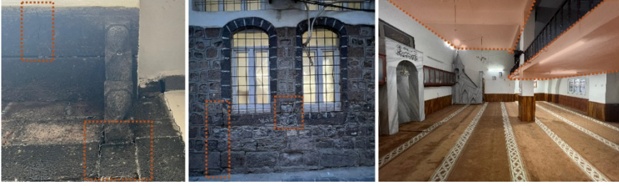
Şekil 6. Taceddin Mescidinde Gözleme Dayalı Tespit Edilen Yapısal Sorunlar
