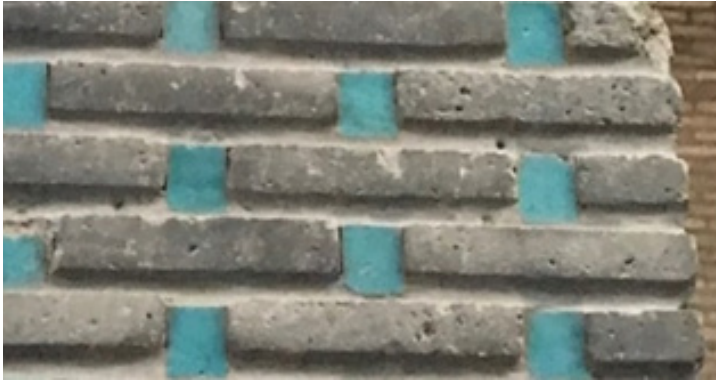
G. 4: Medresenin ana eyvan taç kemerindeki çini parçalardan detay görünüm (M. Erdem Koroğlu, 2022)
