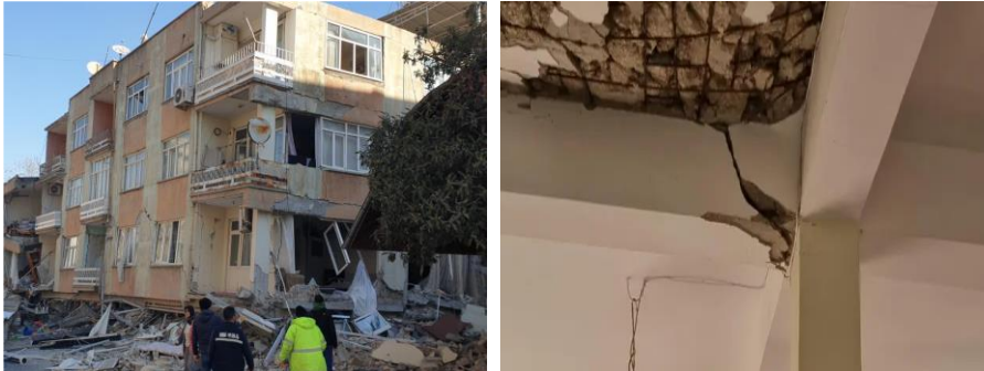
(b) Adıyaman depremi alt katı göçen bina (kirişlerin kolonlarından daha güçlü olduğu bina)
