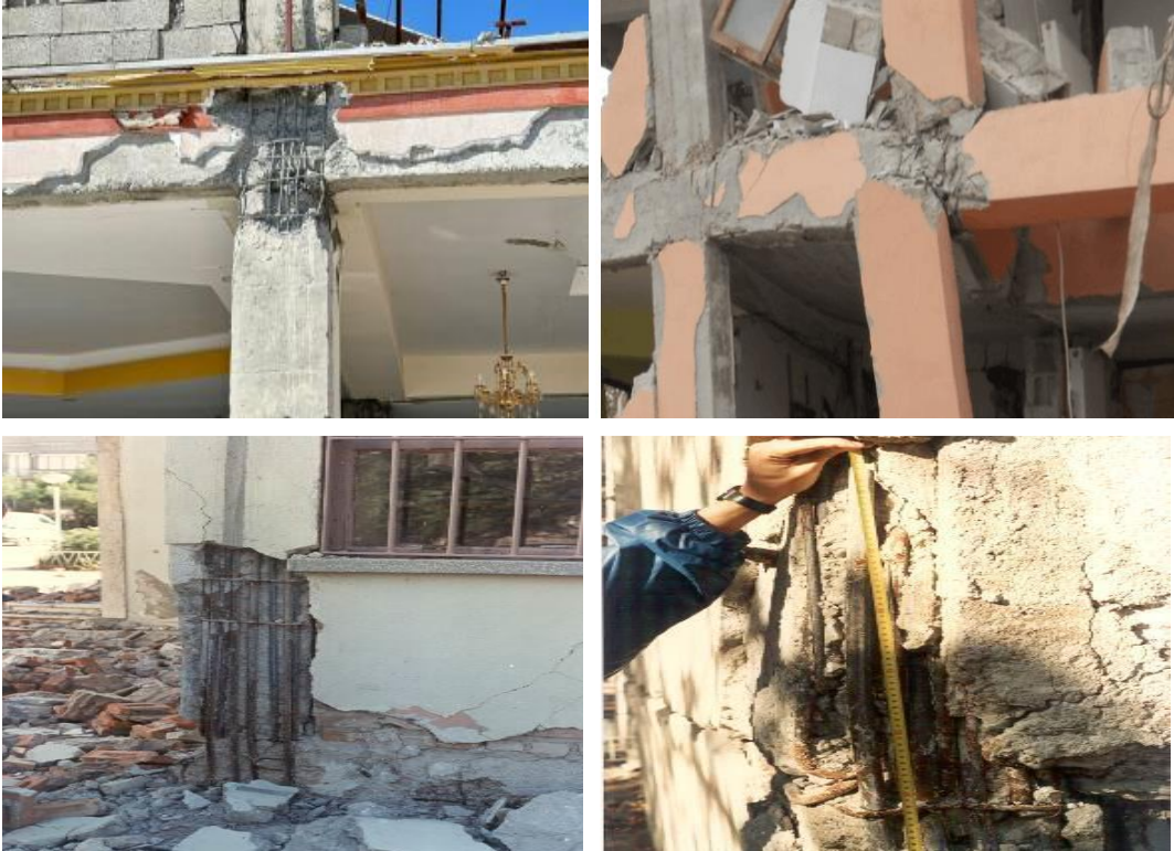
Şekil 3: Kolonlardan meydana gelen hasarlar
