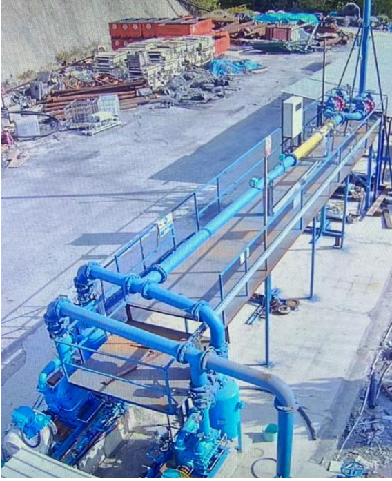
Şekil 17. Yerüstünde kurulmuş metan drenaj pompası.
