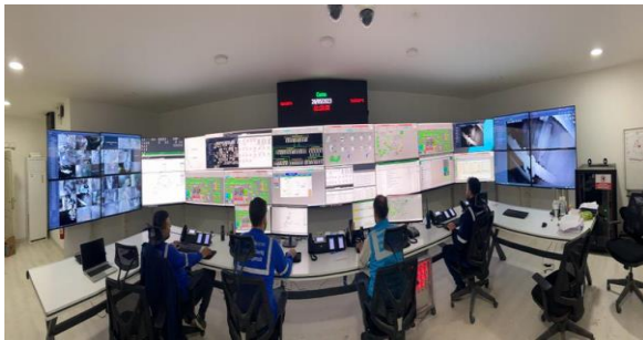
Şekil 6. Yerüstü gaz izleme merkezi.
