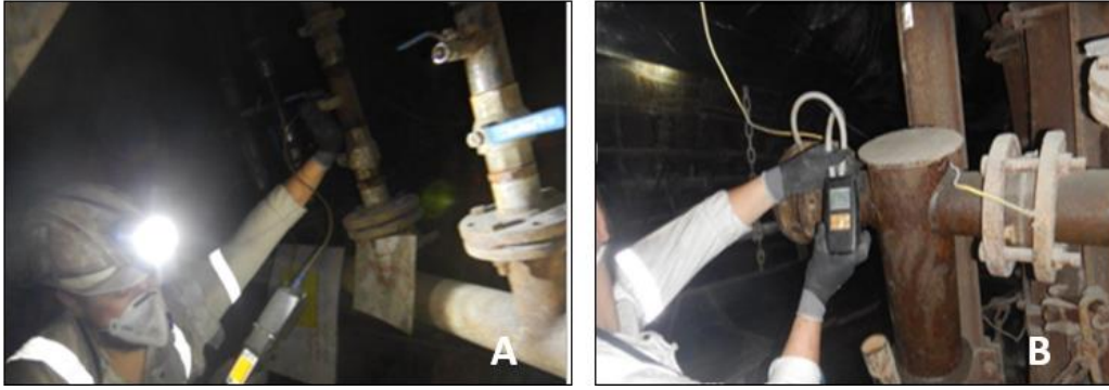
Şekil 15. Metan drenaj şebekesinde yapılan ölçüm ve kontroller. A: Gaz değerlerinin ölçümü, B: Basınç farkı ölçümü.
