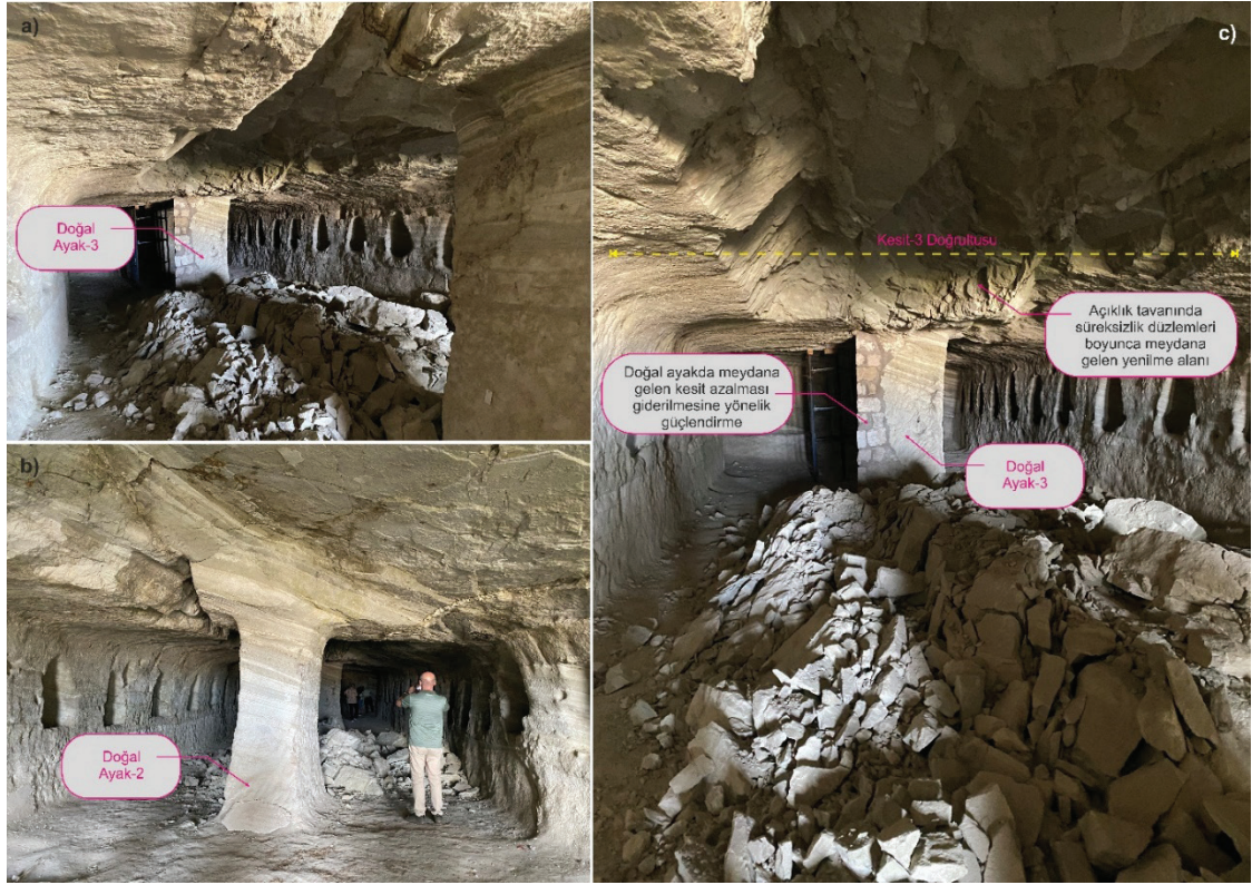
Şekil 17. At Ahırı olarak adlandırılan kaya oyma yapıda 2020 yılında meydana gelen kaya kütle yenilmesinin genel görünümü
